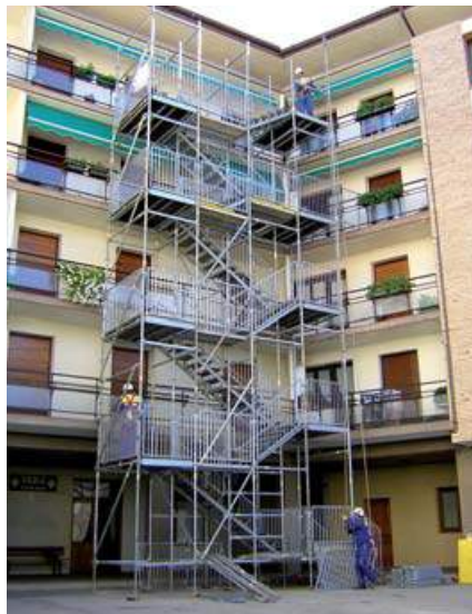
▲ Escaleras de andamios para acceso a viviendas
