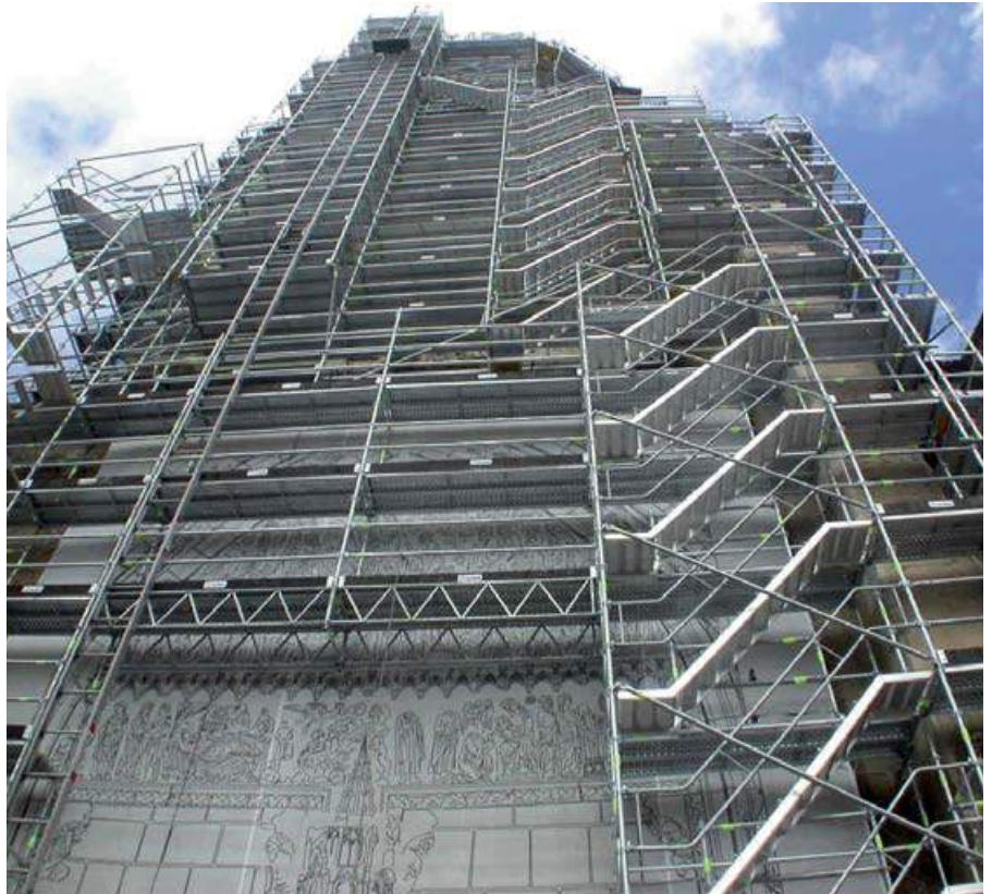
▲ Acceso por escalera adosada al andamio
